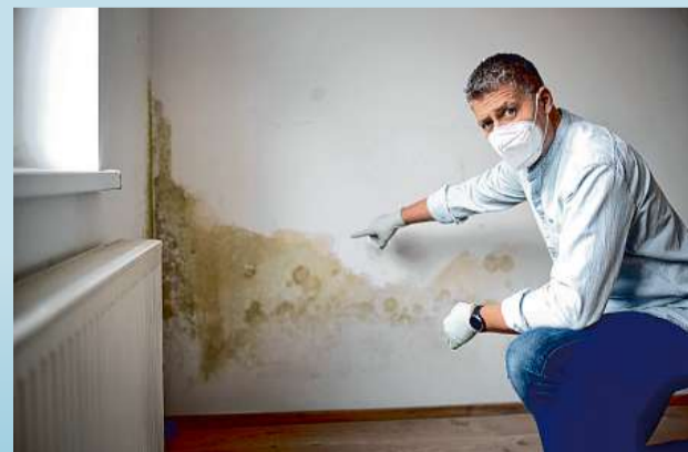
Die Außenecken und Außenwände sind besonders gefährdet Foto: epiximages/stock.adobe.com/akz-o
